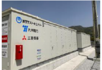
蓄電所の例 出所：NTTアノードエナジー HP
